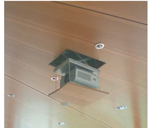
Detail Beamer Stadtwerke Bielefeld
