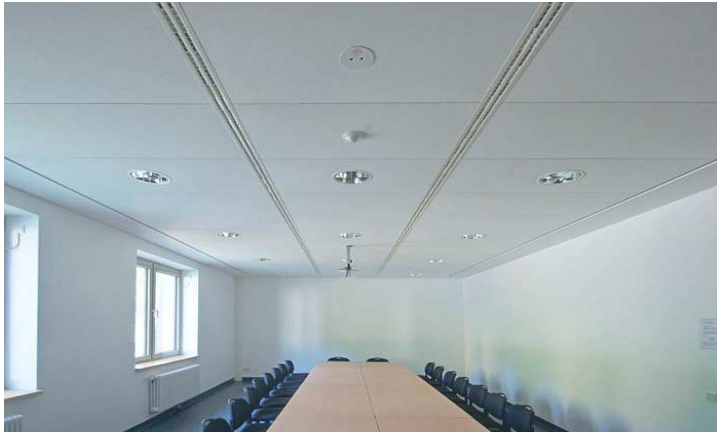
Henning-von-Tresckow-Kaserne Schwielowsee BER Metall-V Akustikplatten Oberfläche BER Strukturlack weiß
